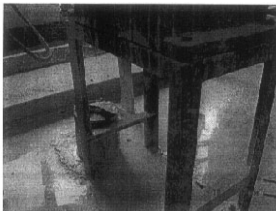
图 3-14 石灰加药泵泵体渗漏情况
