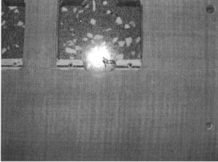
图 6-9 间隙较小造成通长裂纹
