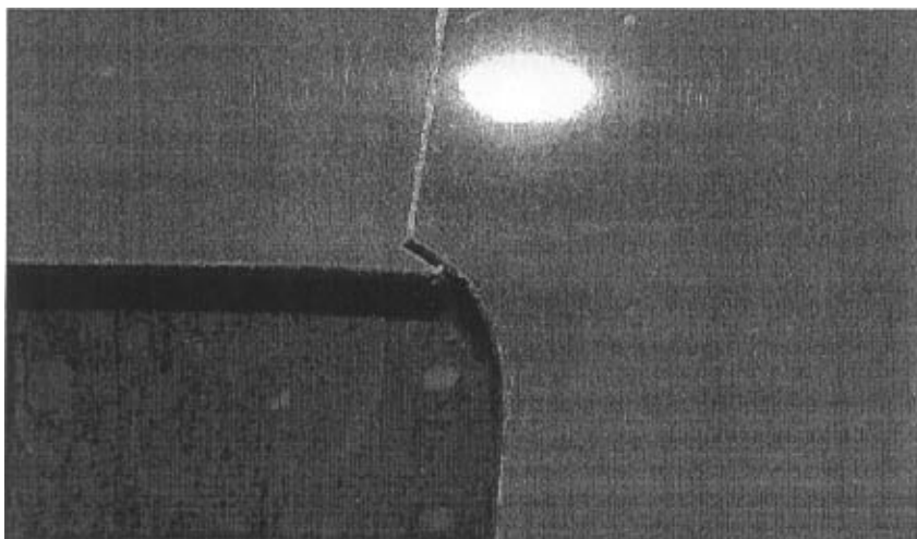
图 5-3 锯口过位防火板裂纹
