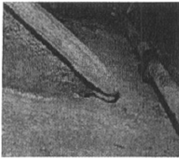
图 1.3 肘板趾部腐蚀 Fig.1.3 Corrosion of bracket toe
