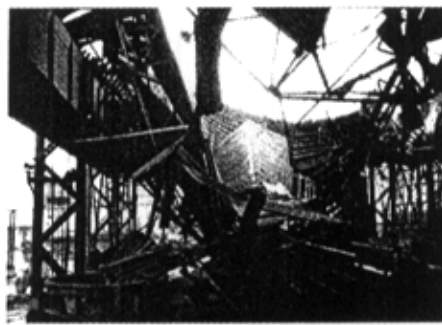
图1-2 厂房屋顶坍塌中心
