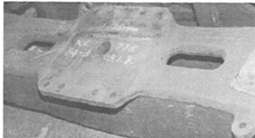
图 2-6 摇枕心盘裂纹的现场照片 [61]
