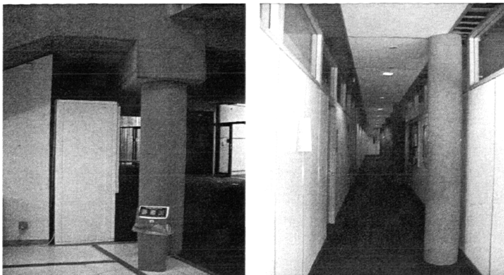
图 4-45 4-46 暴露的混凝土梁柱
