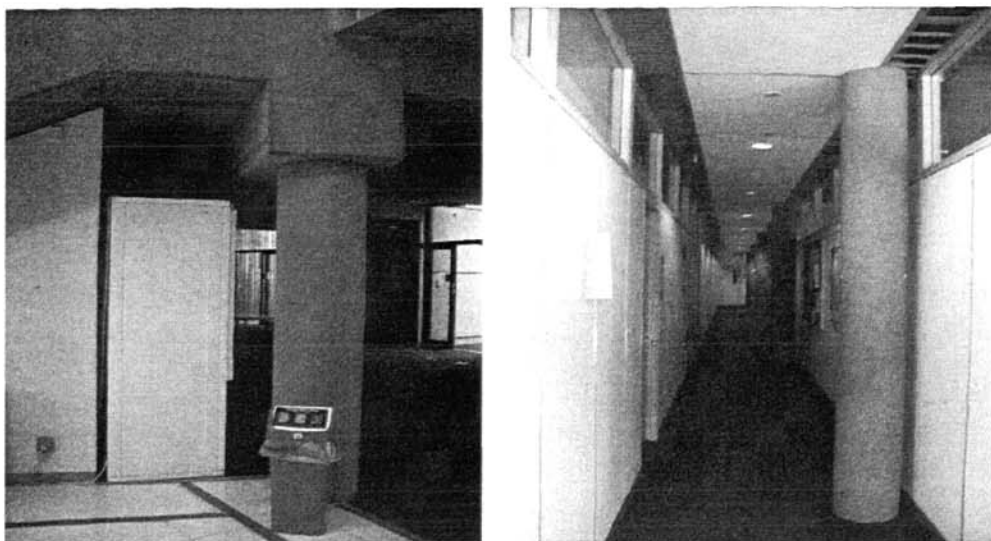
图 4-45 4-46 暴露的混凝土梁柱
