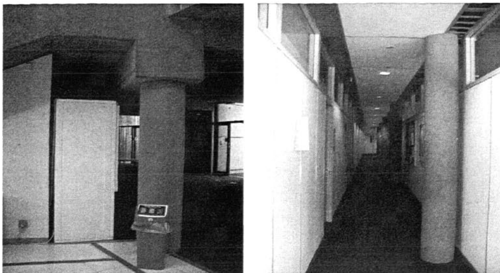
图 4-45 4-46 暴露的混凝土梁柱
