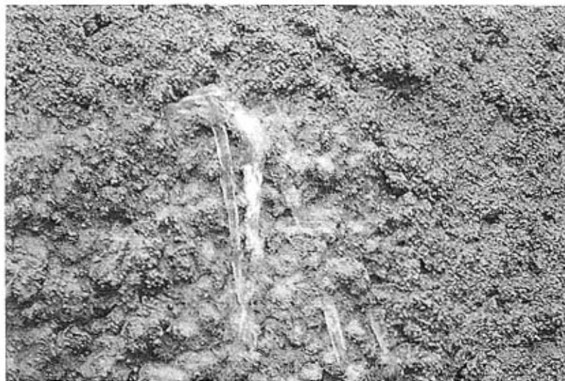
图 3—13 5 月 19 日所拍摄的东侧冠梁上部喷锚面渗水
