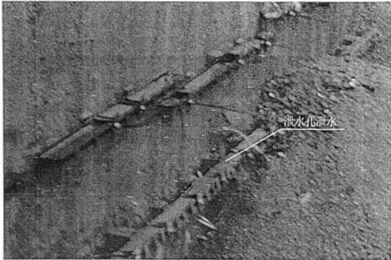
图3—10 暴雨过后-10.0m处泄水孔水流喷出3m左右远
