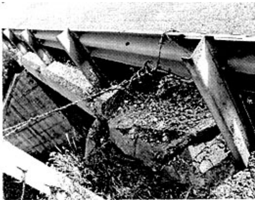
c 桥涵上出现拉裂缝
