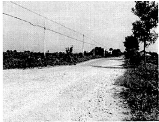
d 公路路面沉降与开裂
