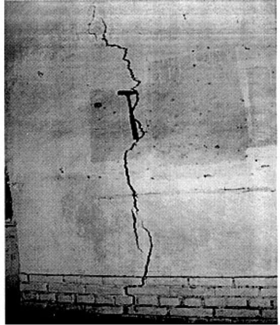
f 墙体开裂 (2)
